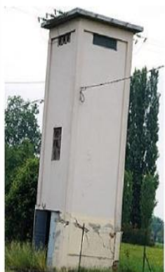
Una cabina Enel a Mortizzuolo
